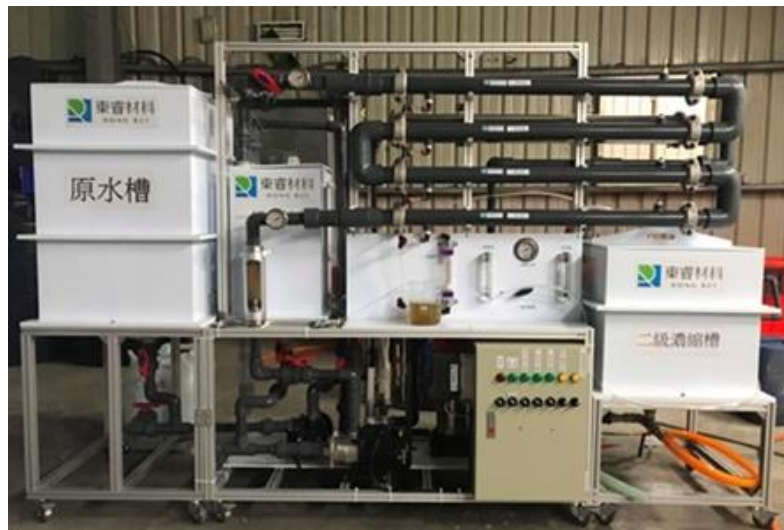
CMP廢液過濾系統-- 回用處理系統
