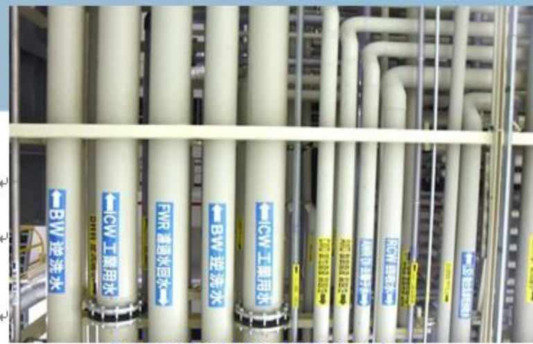
製程廢水分流收集管線
